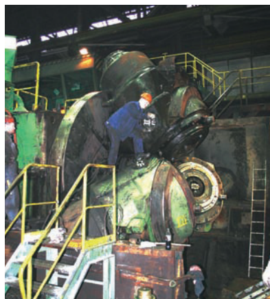
Montaje de los cabezales de laminado en el laminador oblicuo planetario, aquí sin anillo de guía y carcasa del rodamiento de apoyo.
