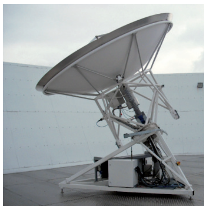
Antenna di 3,7 m di diametro.
